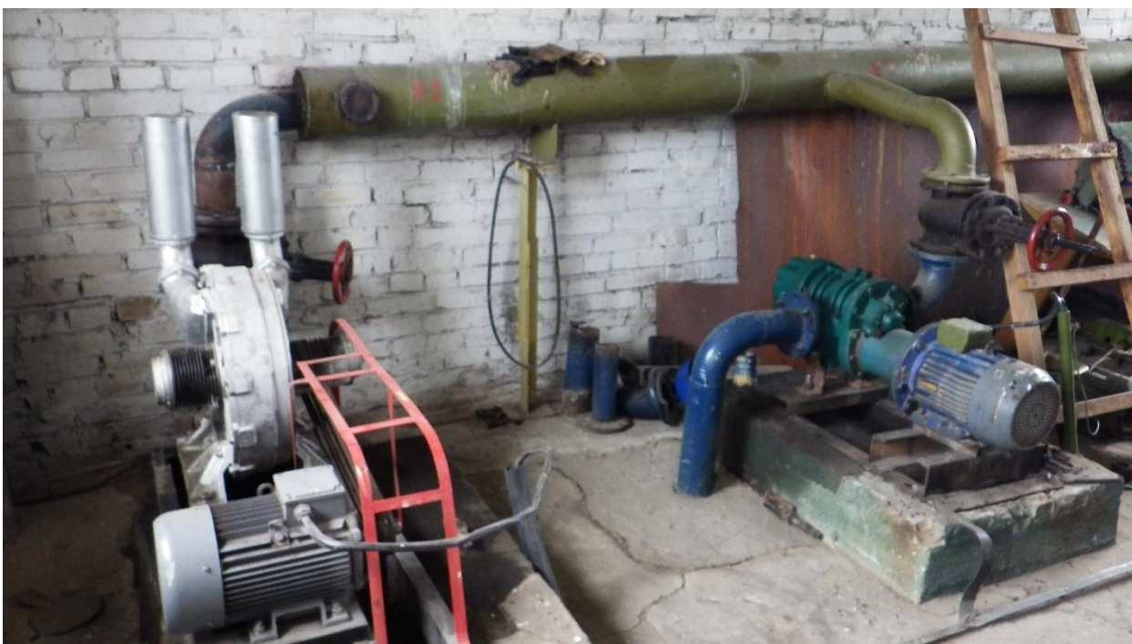
Рисунок 3. Воздуходувное оборудование КОС.
